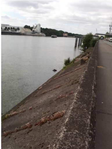
Berges de Seine non aménagées et entièrement minéralisées à Vitry-sur-Seine (Even Conseil)
