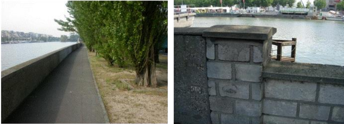
Figure 19 : Murette anti-crues dans le département des Hauts de Seine. Source : CD 92
